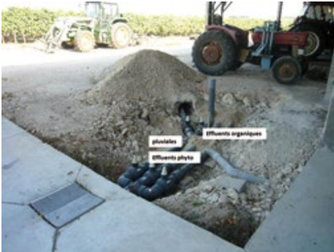
Plateforme de remplissage / lavage Gestion différenciée des effluents en sortie de plateforme
