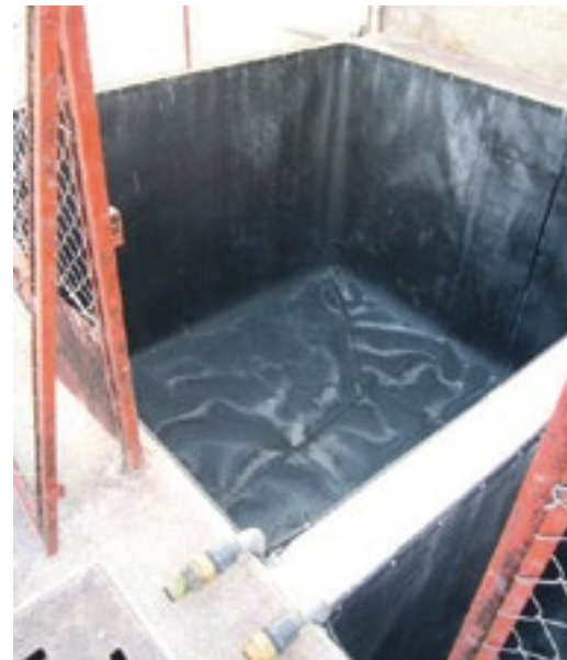
Ancienne fosse à vinasses rénovée pour collecte des eaux de refroidissement distillerie + kit « pompier » avec utilisation comme réserve incendie
